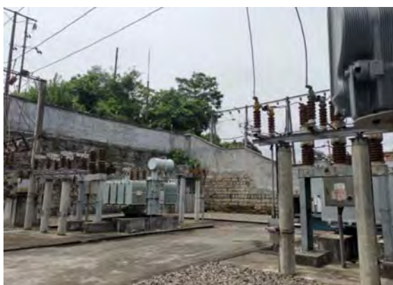
龙山 35kV 变电站现场照片
