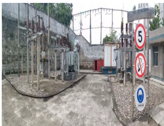
龙山 35kV 变电站内部现场照片
