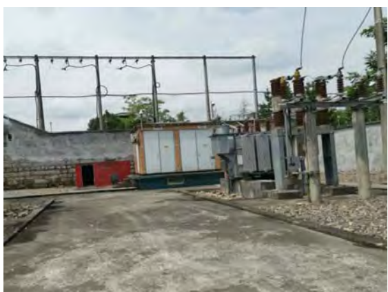
丹巴 220kV 变电站侧现场照片
