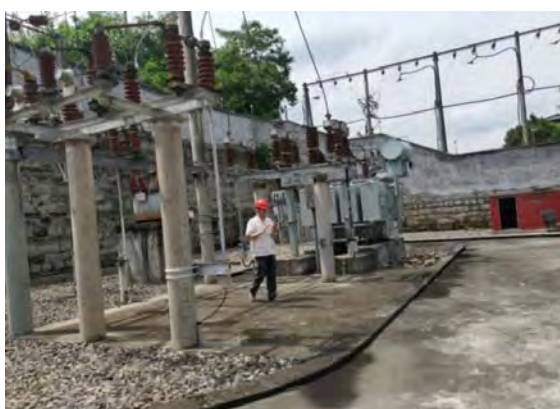
龙山 35kV 变电站现场照片
