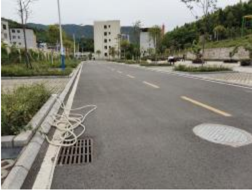
广场区雨水管入口
