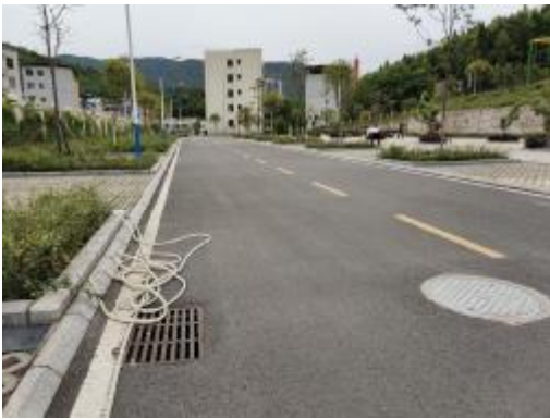
广场区雨水管入口
