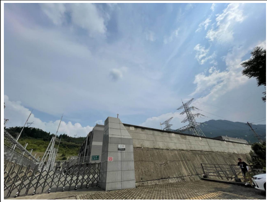
线路终点-明月峡变电站
