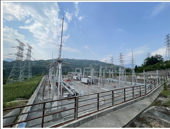
线路终点-明月峡变电站
