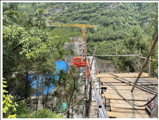
线路起点-八庙沟水电站
