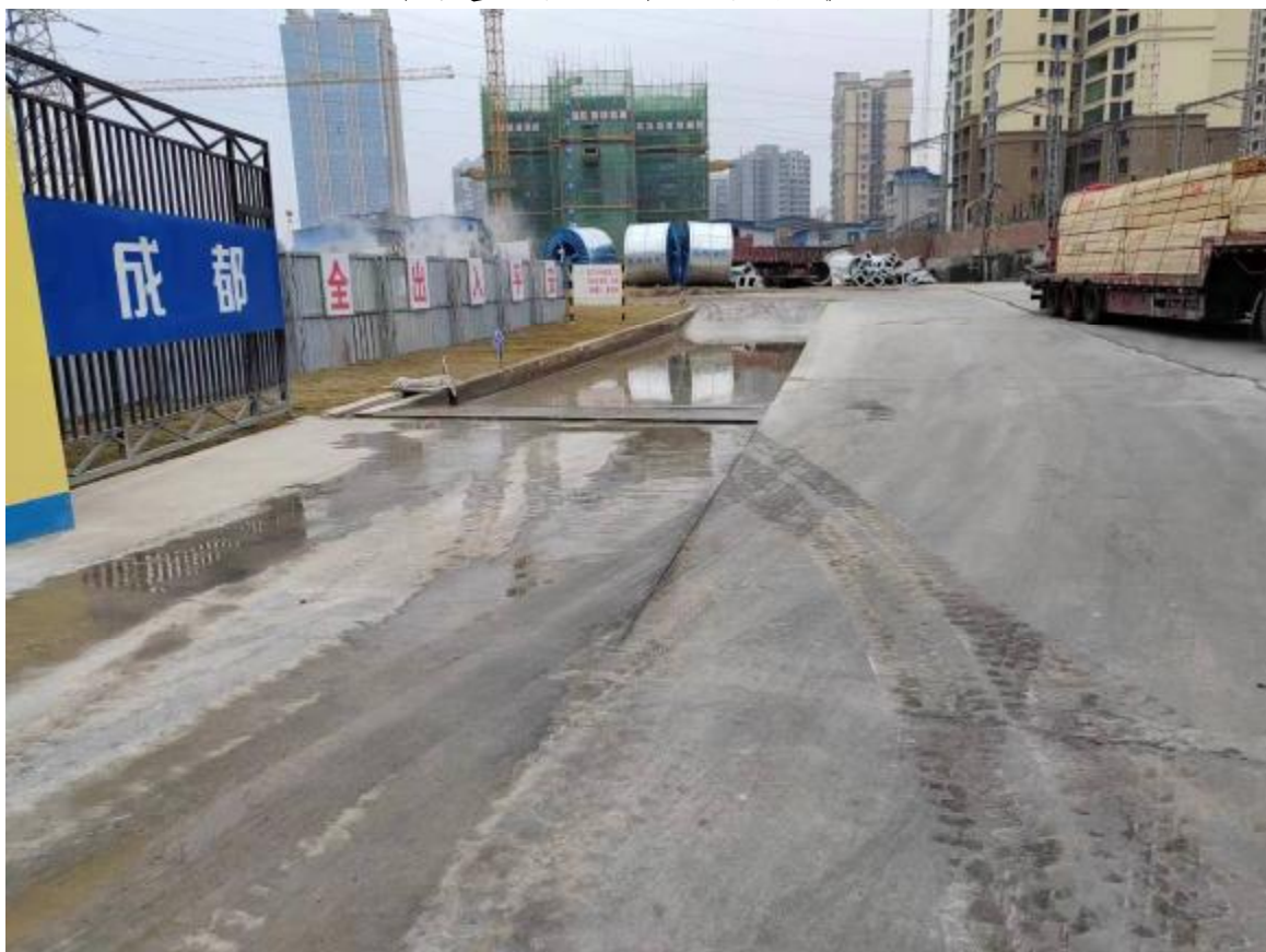
在建工程实施的车辆清洗槽
