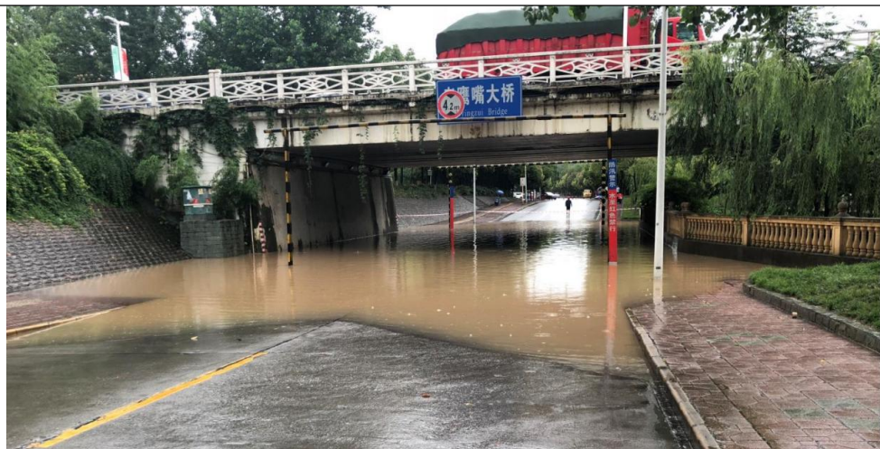
老鹰嘴大桥下穿道路内涝图
