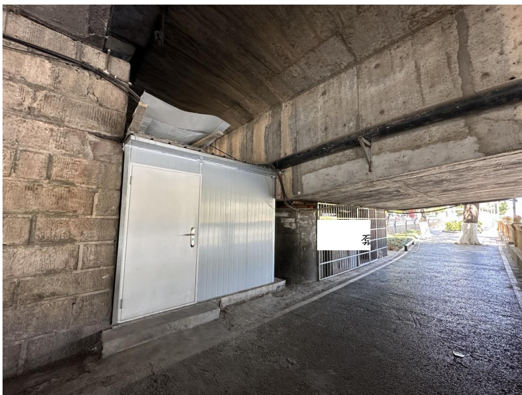
蜀门大桥下穿点位已建泵站
