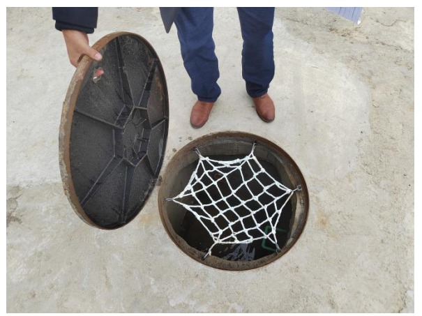
污水管检查井（配套防坠网）
