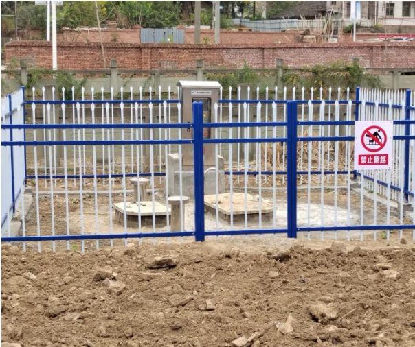
污水提升泵站
