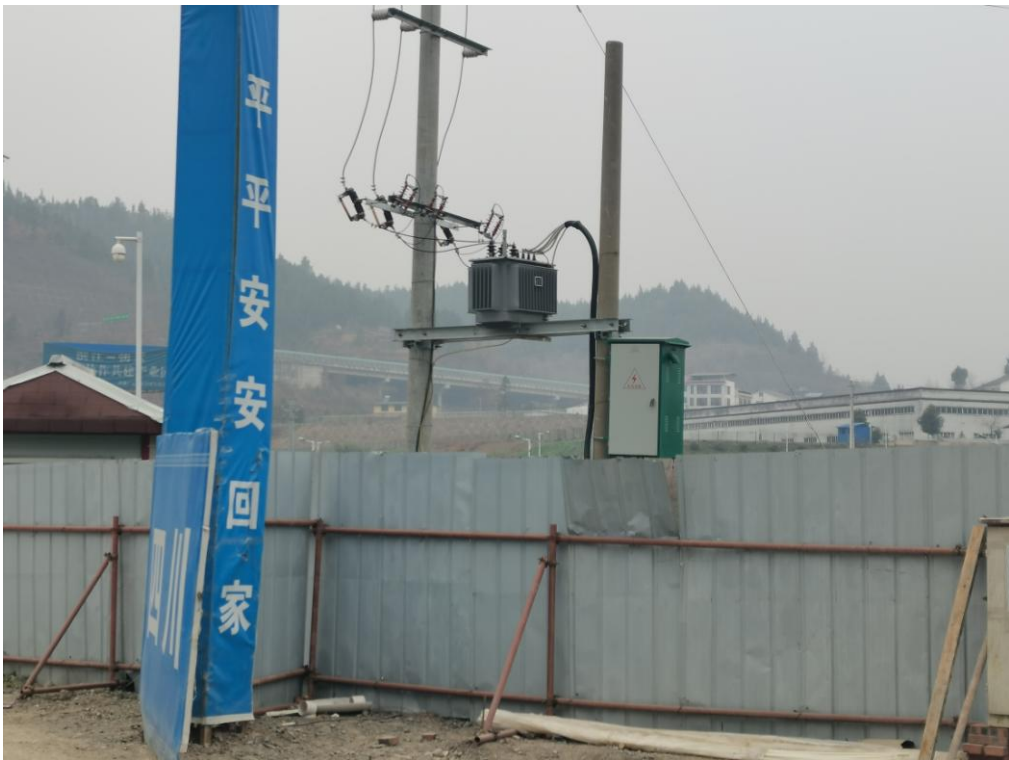
变电设施现状
