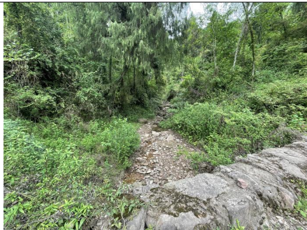
更换段2沟渠现状
