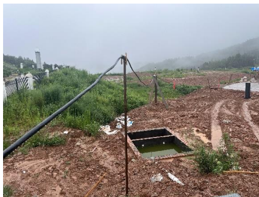
临时沉沙池（拍摄于 2024.8）
