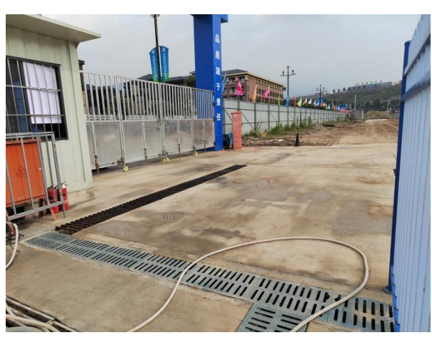
项目已建洗车设备
