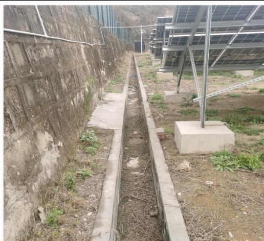
阵列旁侧排水沟（1#地块）
