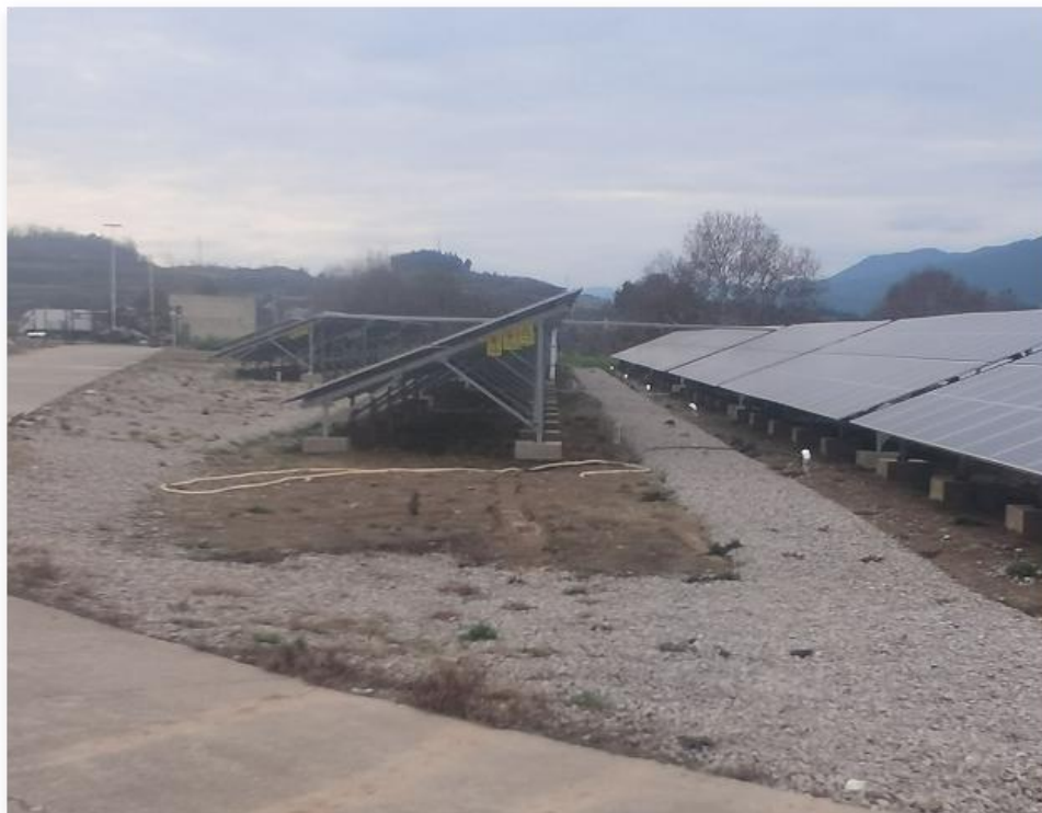
光伏阵列现状情况
