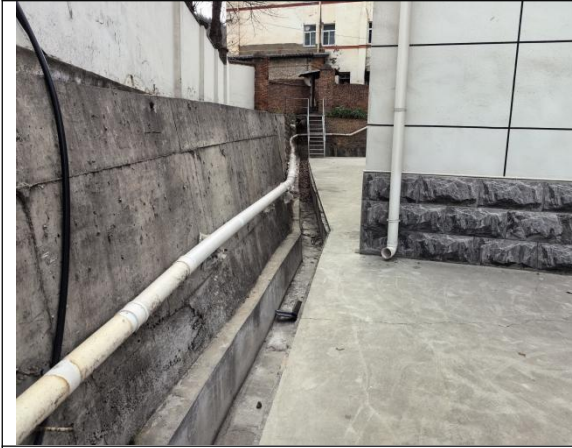
项目已建排水沟
