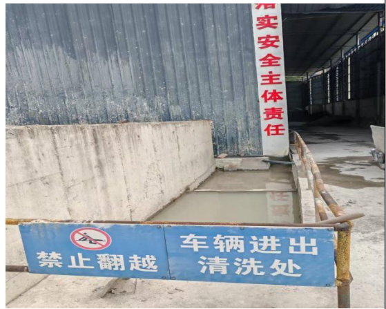
项目已建二格沉砂池
