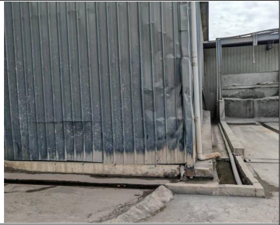
项目已建排水沟
