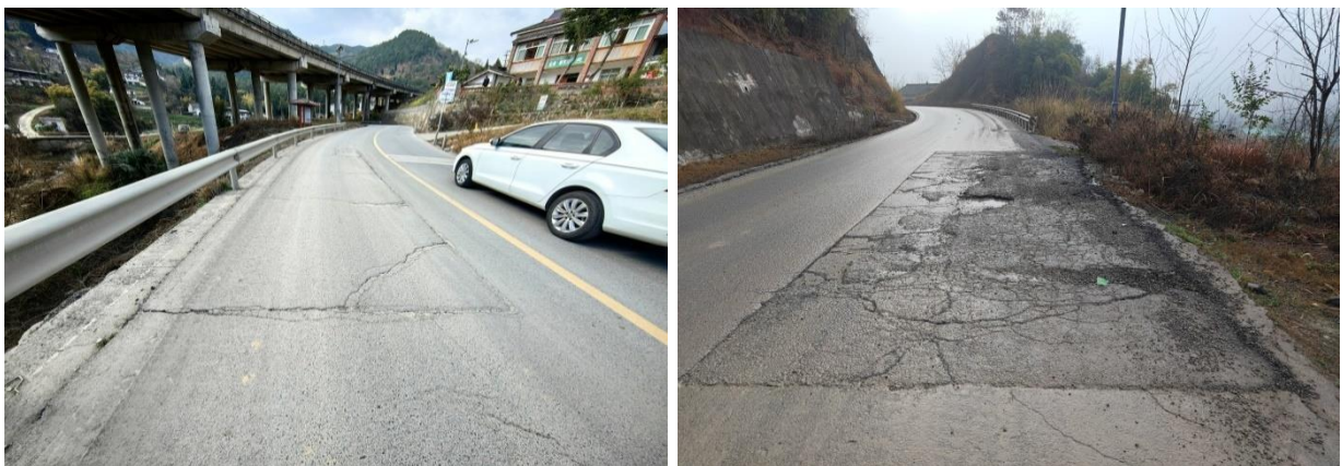
沿线道路病害现状
