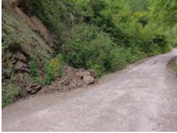
边坡崩塌、边沟堵塞典型病害照片 3
