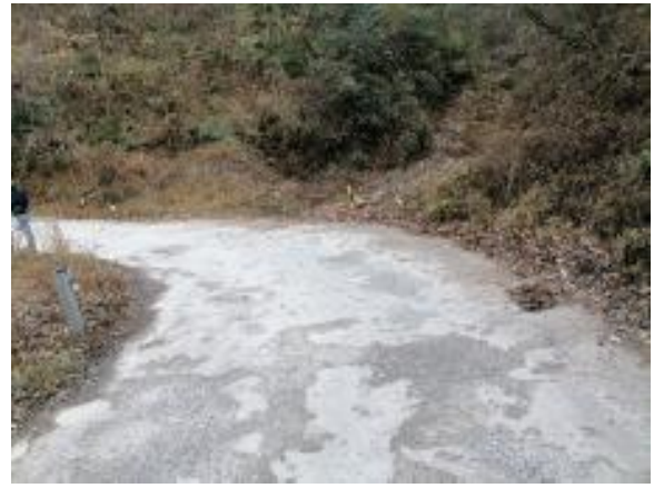
路面病害典型病害照片
