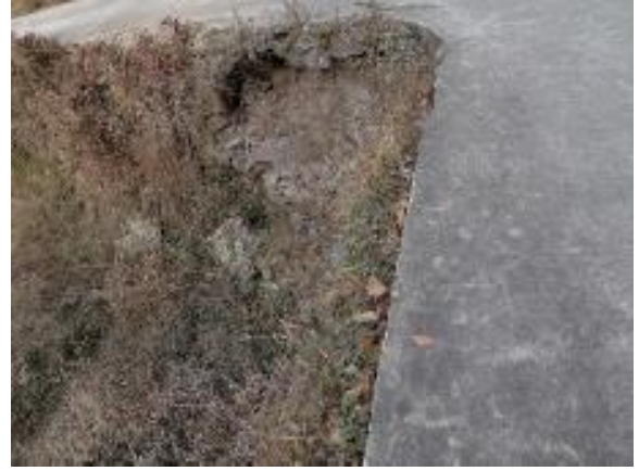
原干砌挡土墙垮塌典型病害照片
