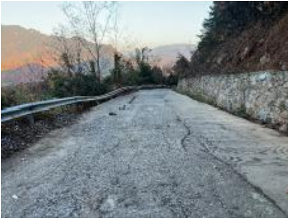
路基沉降、路面破损典型病害照片
