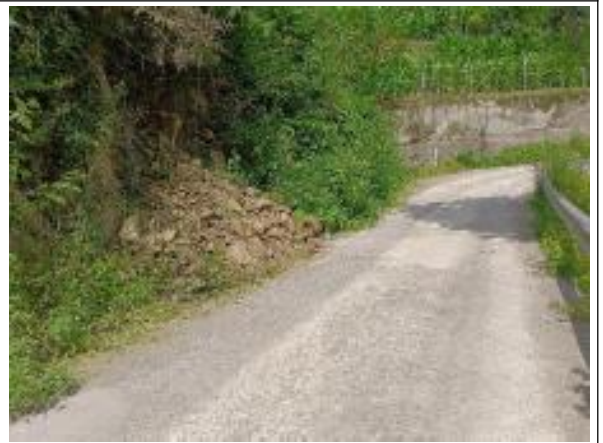
边坡崩塌、边沟堵塞典型病害照片 2
