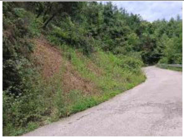
边坡崩塌、边沟堵塞典型病害照片 1
