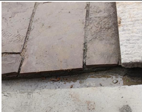
图 5：项目区排水沟现状（一）
