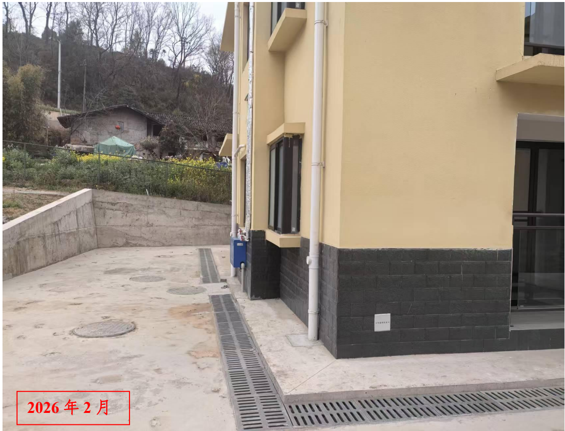
普安中学教师保障性住房排水沟现状照片
