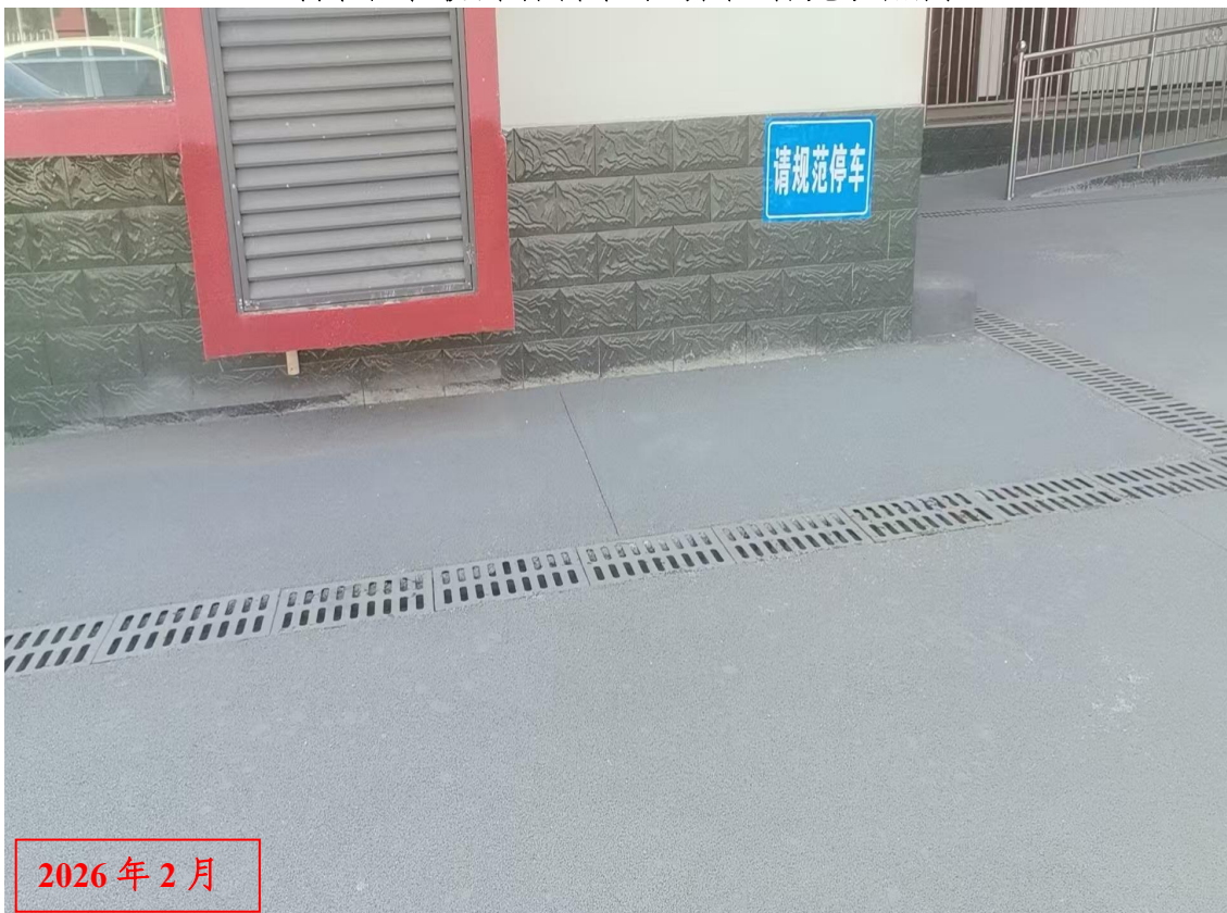
剑门中学教师保障性住房排水沟现状照片
