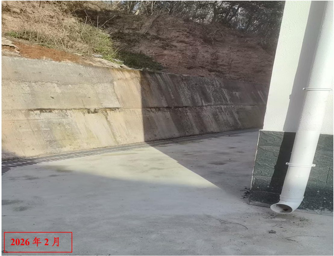
剑门中学教师保障性住房挡墙现状照片
