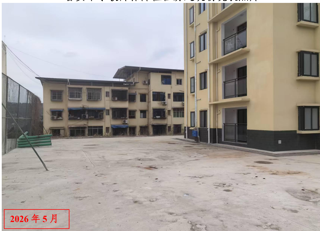
普安中学教师保障性住房道路硬化现状照片
