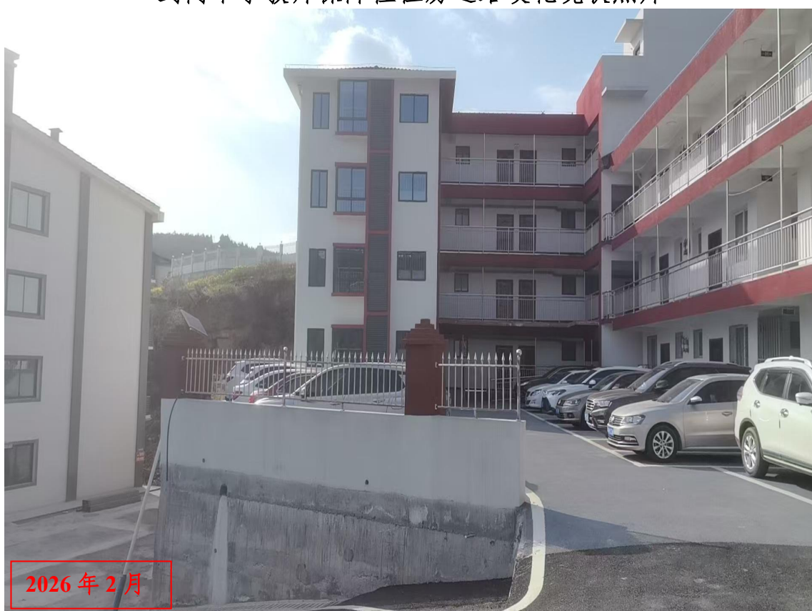
剑门中学教师保障性住房挡墙现状照片
